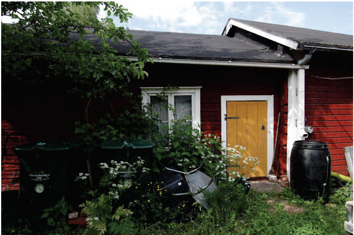
Kuva 10 Makasiinin vieressä on hirsirakenteinen varasto, joka alkujaan on ollut perämökin eteinen. Oviaukko on matala ja ovena on keltaiseksi maalattu lautaovi. Oven vieressä on neliruutuinen pystyikkuna. Kuvan oikeassa reunassa näkyy varsinaista perämökkiä. Se on runkosyvyydeltään hieman syvempi ja räystääslinja on hieman korkeammalla kuin eteisosan. Rakennuksen ulkonäköä on kuvailtu edellä luvussa "Rakennuksen kuvaus".
