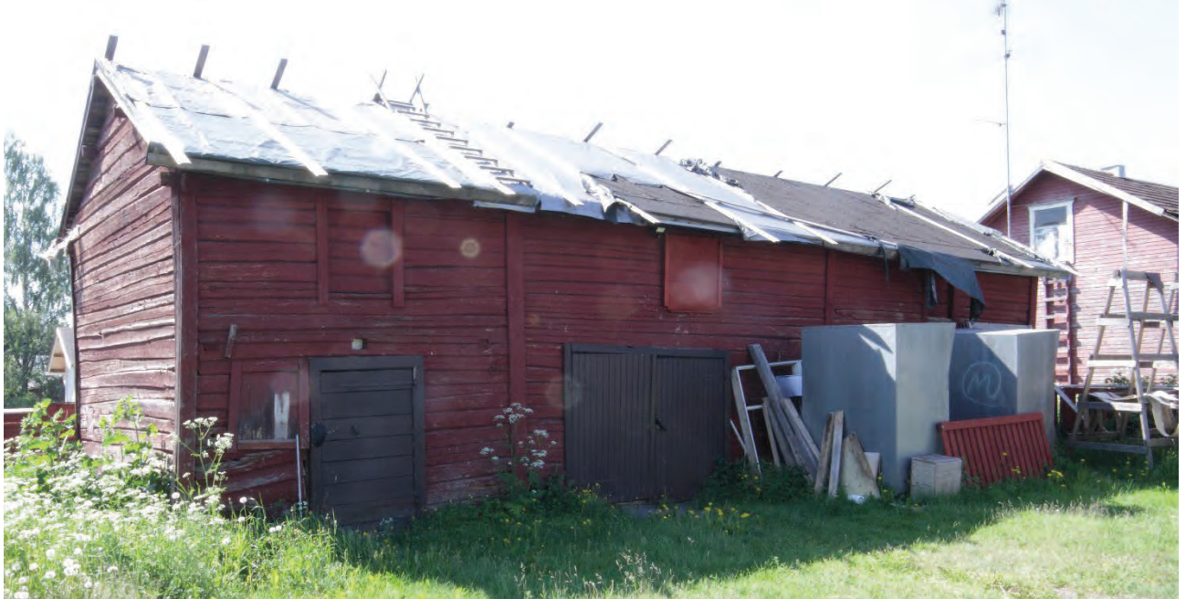
Kuva 2. Kohteessa tontin perällä olevan talousrakennuksen pihanpuoleinen pohjoisjulkisivu. Hirsirakennuksen kattohuopa on repeytynyt talvella 2019.2020 ja repeämiä on peitetty muovilla. Rakennuksen edustalle on varastoitu remontista ylijäänyttä tavaraa. Rakennuksen ulkonäköä on kuvailtu edellä luvussa "Rakennuksen kuvaus".
