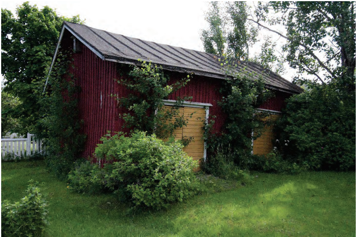
Kuva 5 Autovajaksi vuonna 1912 rakennettu piharakennus sijaitsee pihapiirin perällä. Rakennuksessa on säilytetty ainakin 1920-luvulla Väinö Toivolan takseja. Toivola oli yksi Raahen ensimmäisiä taksiautoilijoita.
