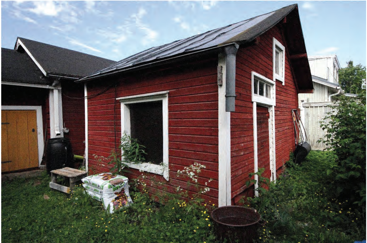
Kuva 12 Tontin perällä on entinen sauna. Alkuaan rakennus on ollut pidempi ja siihen sijoittunut navetta ja huussi. Rakennus on tyhjiällä tällä hetkellä, eikä sitä käytetä saunana. Ikkuna-aukko on peitetty levyllä, mutta se on kooltaan vastaava kuin 1930-luvun valokuvan ikkuna. Saunamökin vesikate on käsin saumattua peltiä, joka erottuu myös 1930-luvun valokuvasta.
