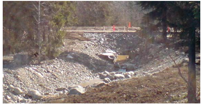
Rakenteilla oleva "Sudenreikä" mereltä Satamalahdelle. Maaperän savipitoinen moreeni on routivaa, pinnan humuskerros on ohut.
