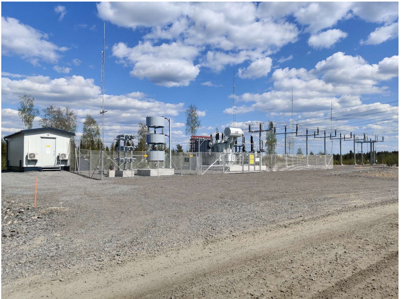
Kuva 4 Sähköasema ja SCADA-rakennusalue
